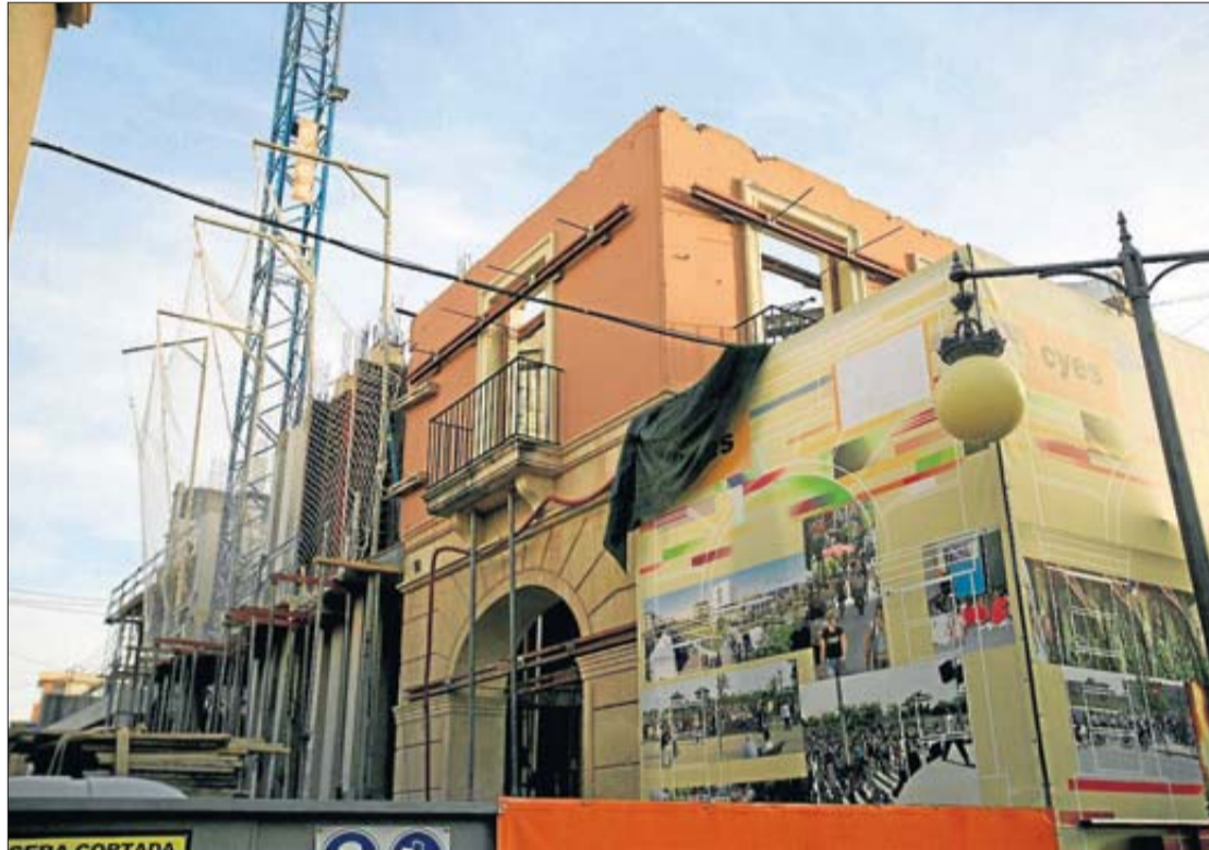
Situación actual de las obras de reconstrucción del antiguo Ayuntamiento. JORGE BONELLI
